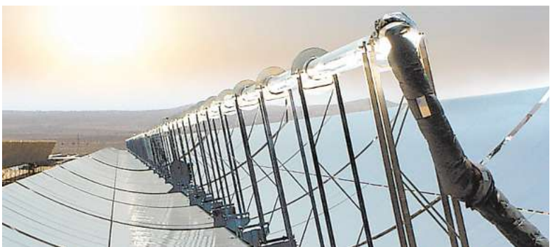
Solarthermisches Kraftwerk mit Parabolrinnen-Technologie.
